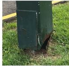
Corrosión y deterioro De estructura
